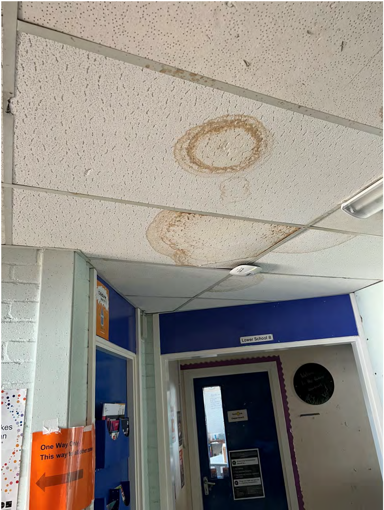
Photo N.1 water staining to ceiling tiles in corridor
